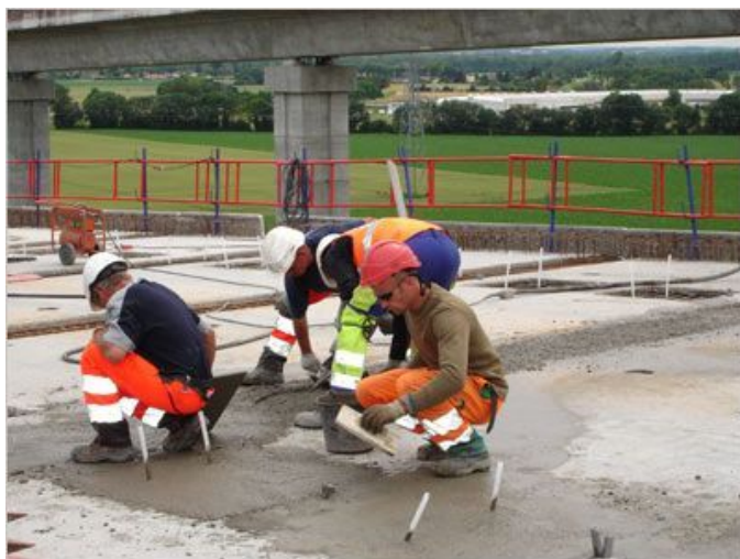
Finition manuelle du bétonnage du clavage. Fournisseur de béton sur ce chantier
