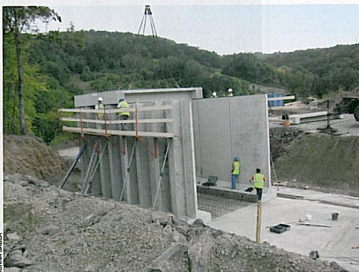
L'ouvrage préfabriqué en usine par Bonna Sabla est monté sur le chantier, puis posé par les équipes de l'entreprise Charier TP.
