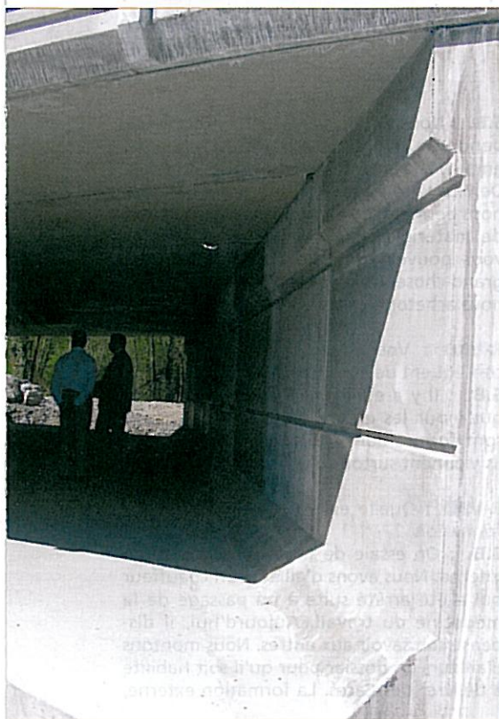
La différence entre les ouvrages hydrauliques coulés sur place et ceux dont les éléments ont été livrés préfabriqués réside essentiellement dans la présence de joints, dans le second cas
